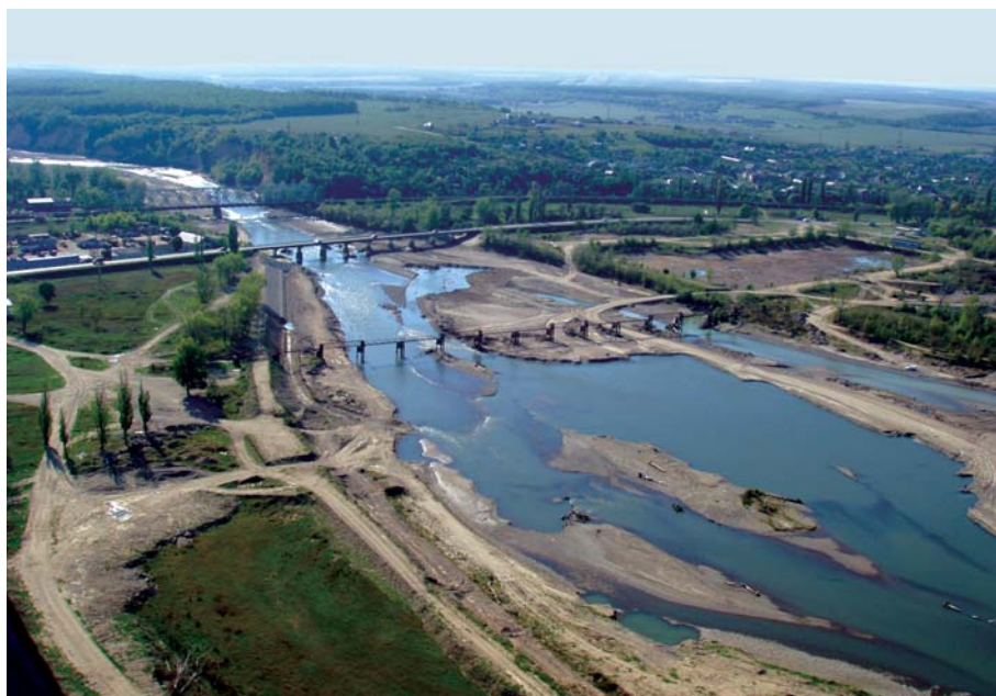
Рис. 4. Река Белая в районе г. Белореченск, подмыв опор моста и газопровода.
