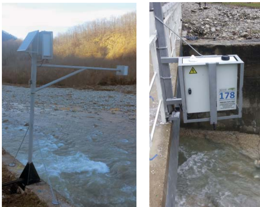
Рис. 2. Примеры установки гидропостов.
