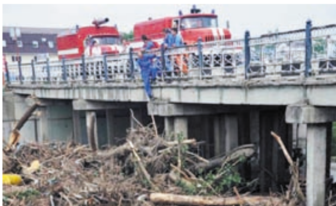
Рис. 1. Характерный вид заломов моста [2]. Fig. 1. Characteristic view of the bridge logjams [2].
