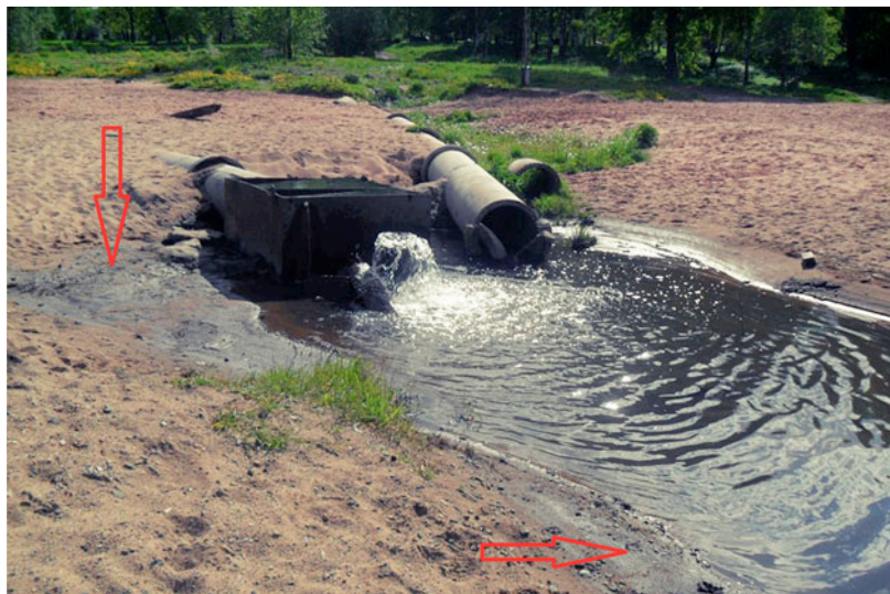
Рис. 5. Сток № 5 ливневой канализации г. Петрозаводска в Петрозаводскую губу Онежского озера (стрелками указано загрязнение прибрежной зоны нефтепродуктами).
